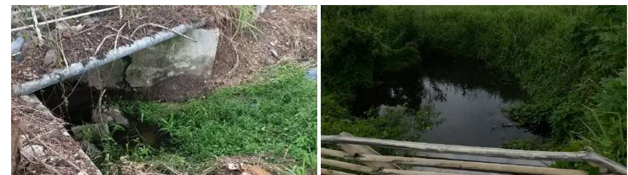
Figure 60 : Amont et aval de l'ouvrage de franchissement de la ravine des Coudes au niveau de la route de Méthivier (photographies : Egis, 2018)
