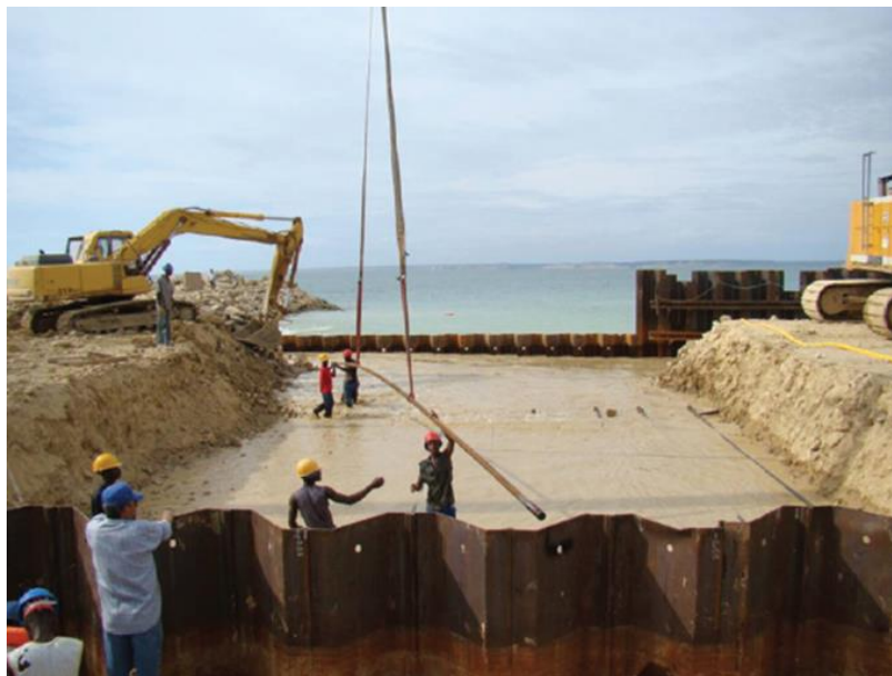
Figure 24 : Exemple de mise en place de tirants entre un rideau principal et son rideau d'ancrage NB : le chantier illustré est de taille supérieure à celui associé au projet (Source : Egis Ports, 2016)
