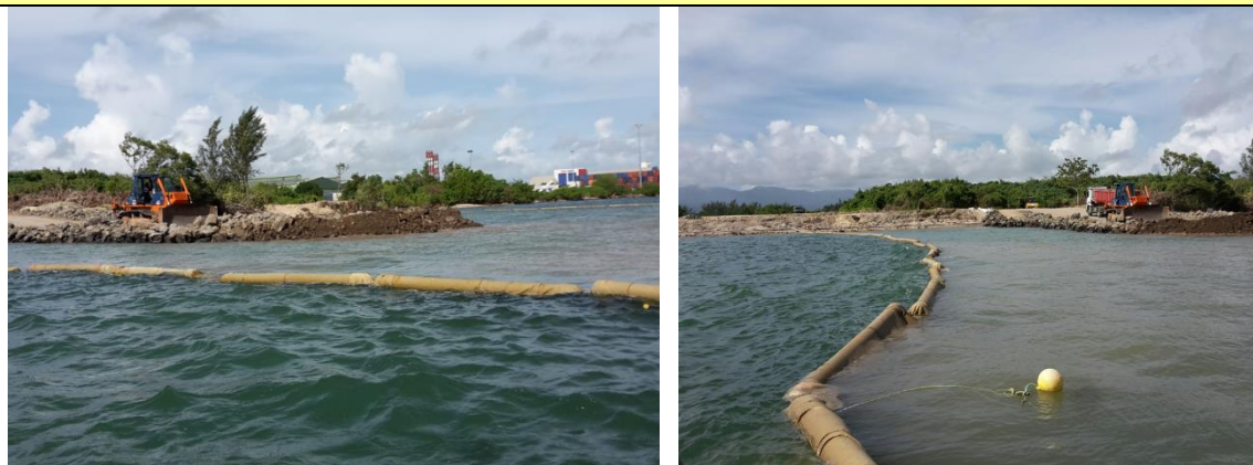
Figure 104 : Barrière Anti-MES de type géotextile mise en place sur les travaux du terre-plein (Source : G. Hébert)
