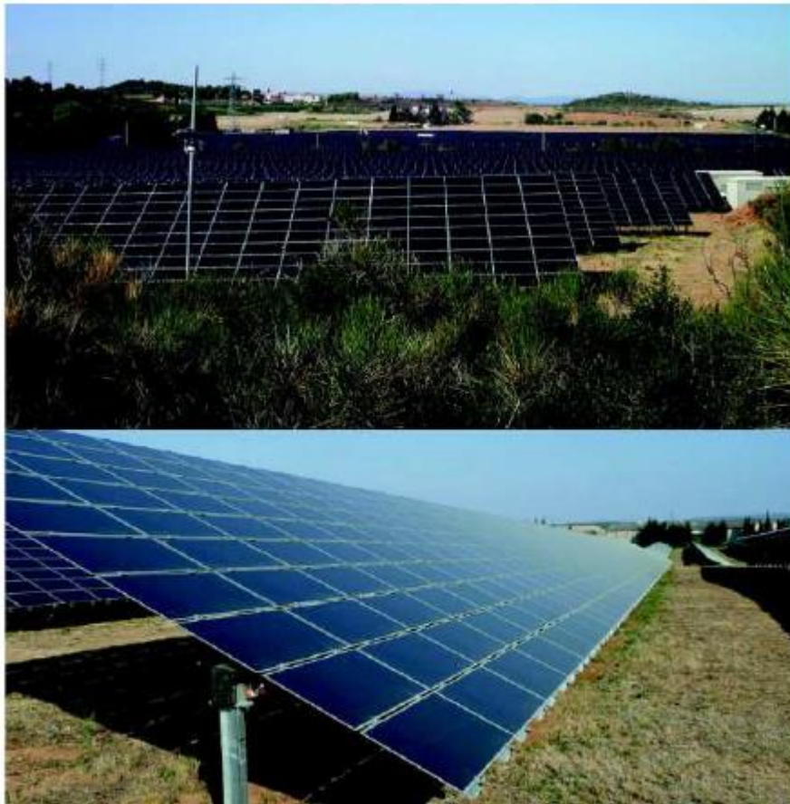
Figure 9 : Exemple de centrales photovoltaïques au sol vues de face et de profil
